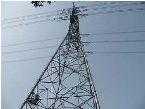
緩々と上り詰めると、シカ避けネットに囲まれた銀色に輝く鉄塔130である。反対側の尾根にルートがある。
