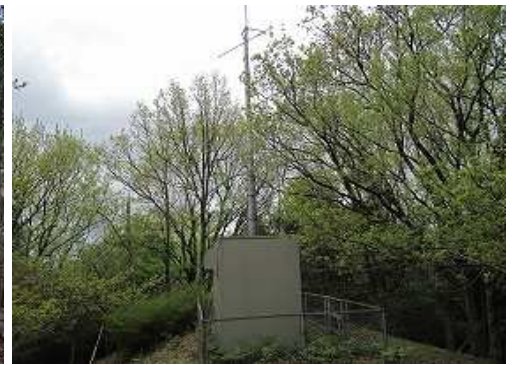
緑川ダムの中継所が建っている。
