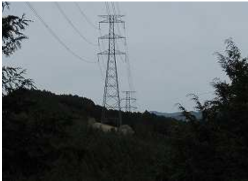
開けた所から北西方向に延びる熊本幹線の鉄塔を望む。
