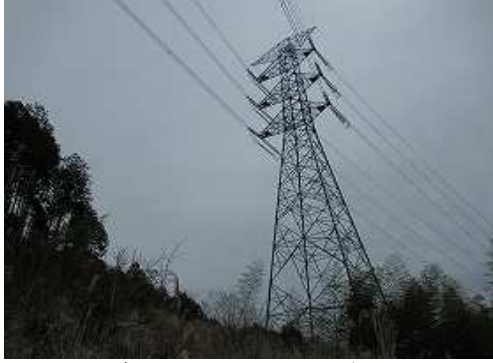
南東に鉄塔47号を見上げる。
