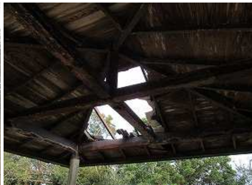
東屋の天井は破れていた。
