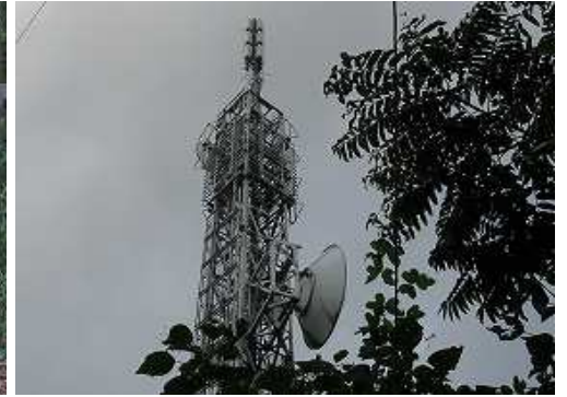
北西に中継塔を見る。
