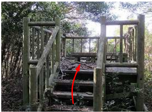
南に面して展望台があるが、随所に傷みが見られる。
