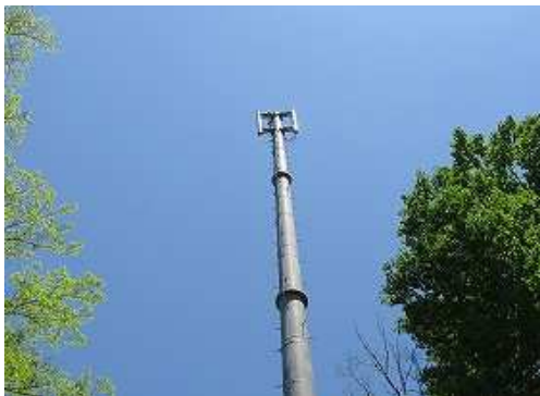
北側に携帯基地局を見る。
