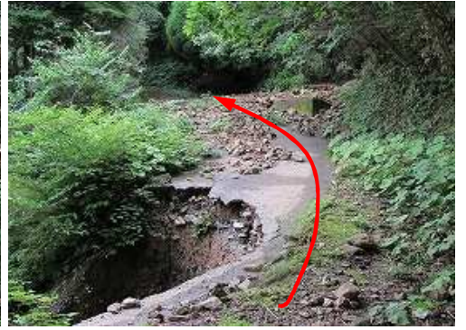
土砂崩れを通過する。
