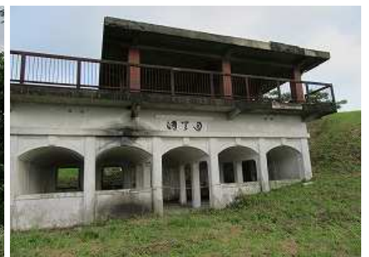
通天洞の屋上は増築され東休息所となっていたが、建物老朽化により立入禁止となっている。
