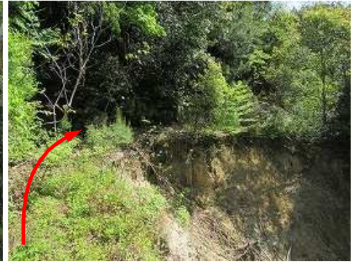
路肩崩落の傍を抜ける。
