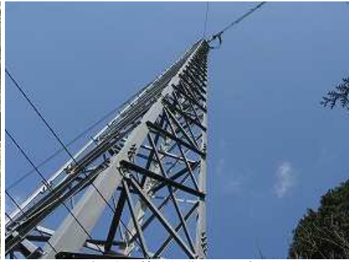
直ぐ左に補助鉄塔を見上げる。
