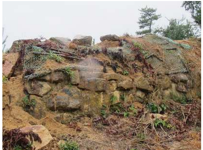
北門左の石積の裏込め状態。
