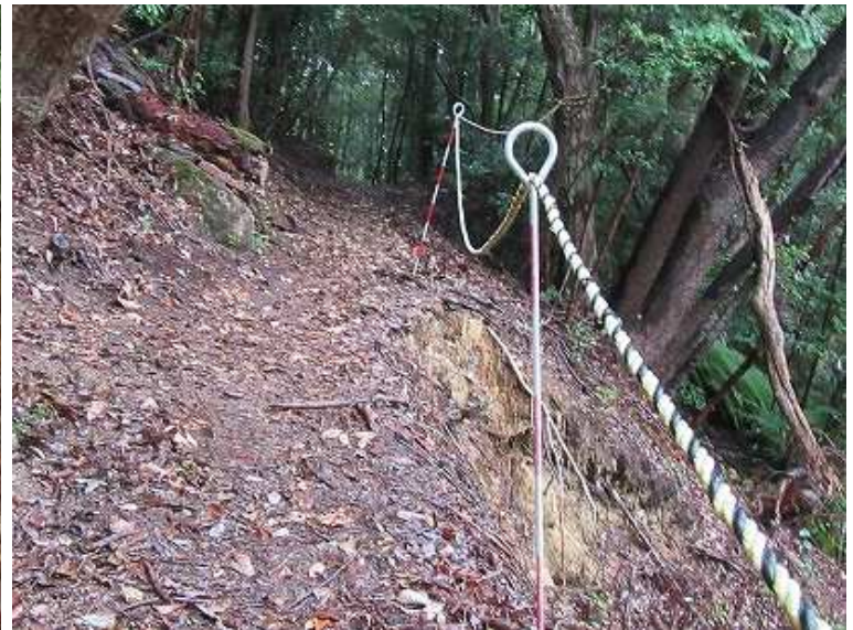
8:16 トラロープが張られた崩落斜面の上部に行く。
