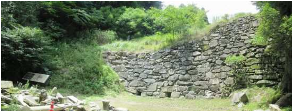
石垣も左側に土砂崩れが起きているが、今だ手が付けられていない。
