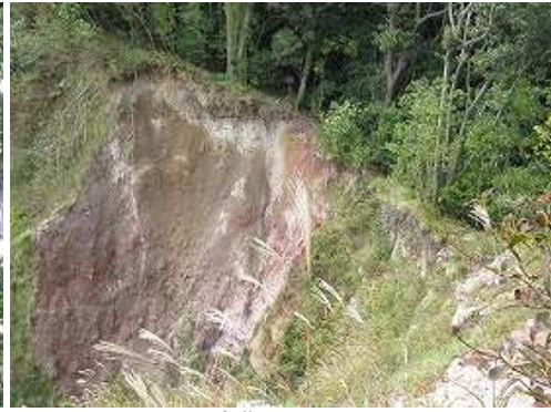
崩落地を見る。
