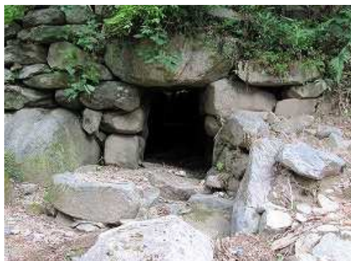
奥が塞がれており樋管に水の流れていない。
