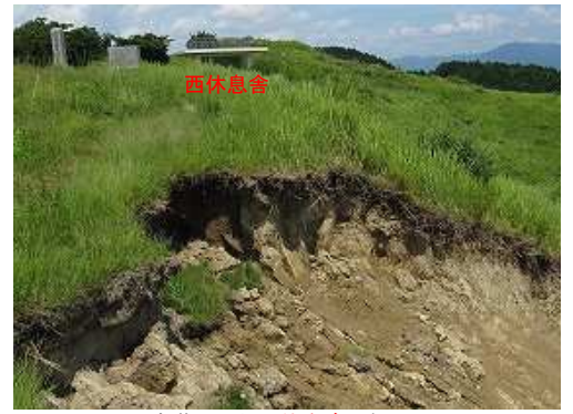
崩落地から 西休息舎 を望む。
