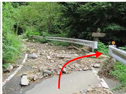
米倉入口の上部にも土砂流失が見られる。
