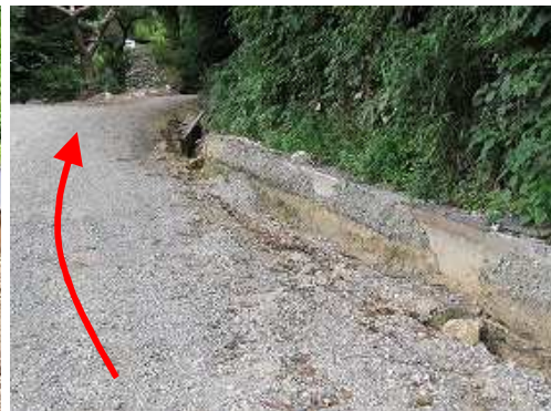
舗装路は浸食され路床部まで流されている。
