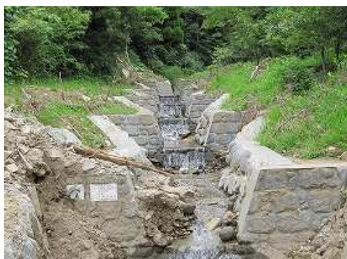
荒れた流路工。
