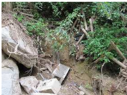
東側の水門跡登山口の取付きも流失して取付けない。
