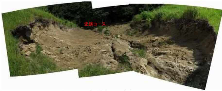
上部から見た 草原崩落 で下に史跡コースが通る。
