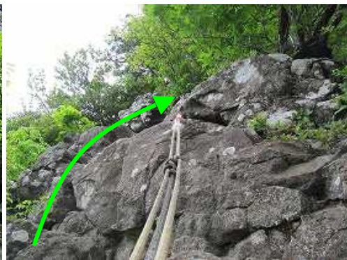
残置ザイルの劣化が進んでいる。
