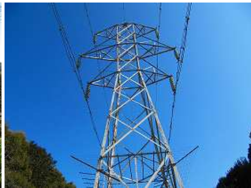
左側に68鉄塔を見る。
