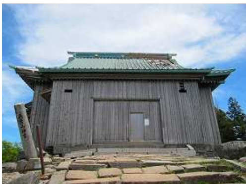
英彦山上宮に参拝する。未だ屋根は補修されていない。
