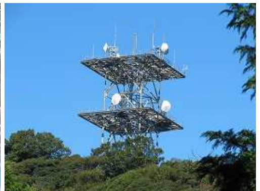
北西の開けた所から送信アンテナが望まれた。
