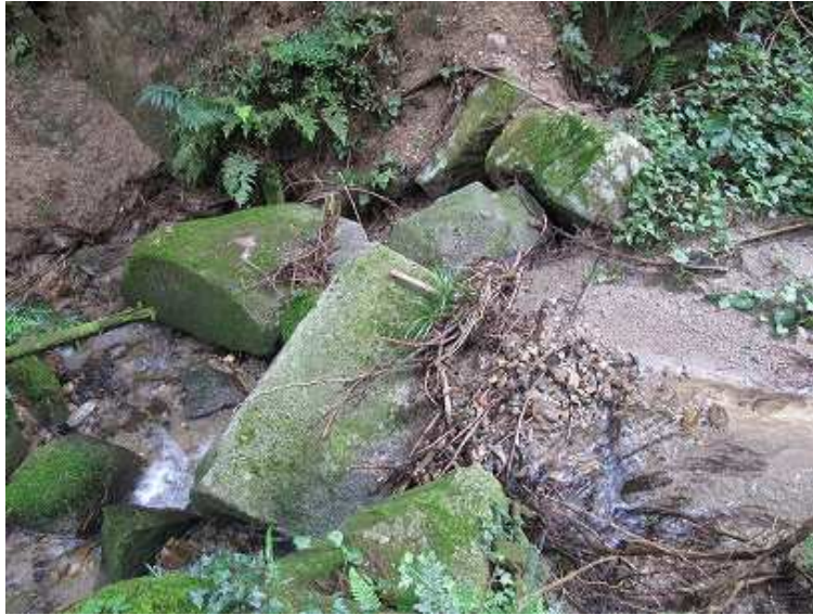
南水門右側であるが崩壊している。
