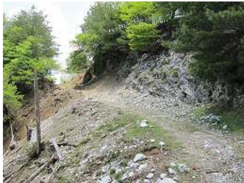
緩やかに林道を歩く。所々で路肩が崩落している。
