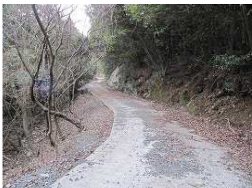
コンクリート舗装が現れるが長続きしない。
