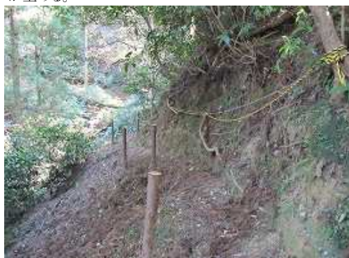
崩壊斜面の上部をトラバースする。
